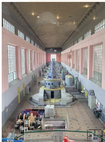
La salle des machines
